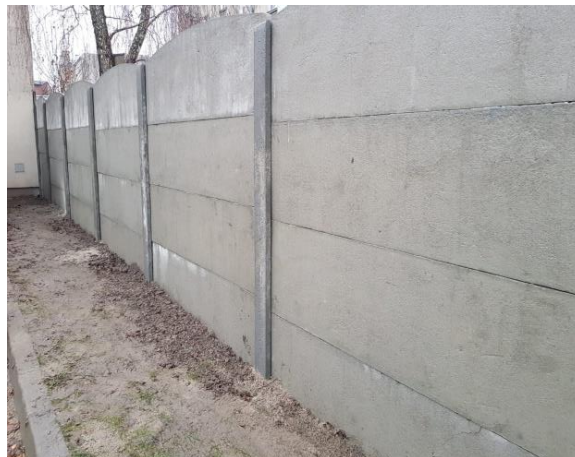
Fot. 2 Płot na terenie JRG
