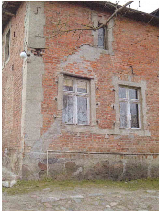
Fot.1. Budynek mieszkalny w obrębie osuwiska
